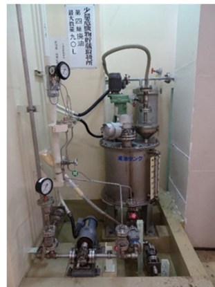
有機溶媒貯槽( \beta \cdot \gamma 固体処理棟Ⅲ)
