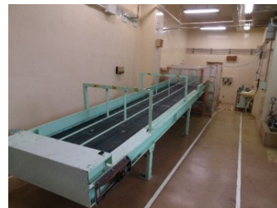
固体廃棄物投入機
