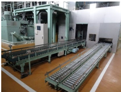
廃棄物搬送設備
