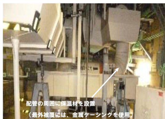
(2次主冷却系の配管)
