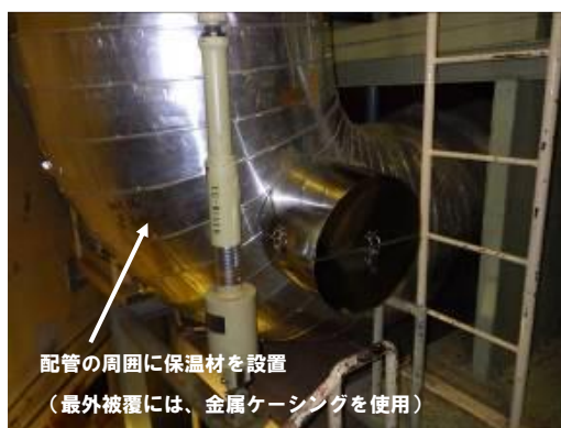
(1次主冷却系の配管)
