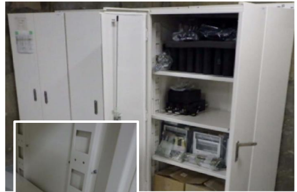
キャビネットの内部
