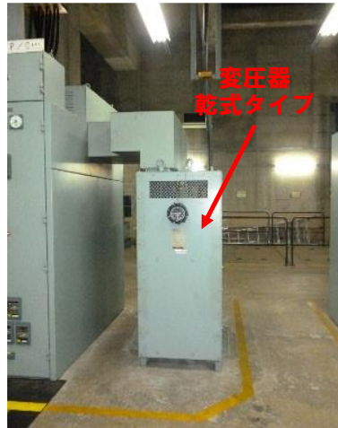
第 3.1 図 変圧器の一例
