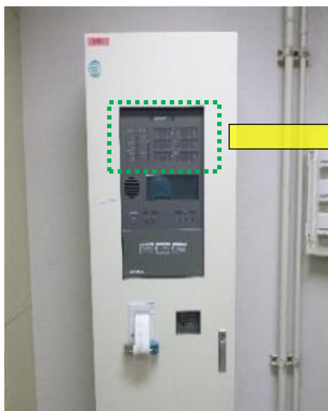
防災監視盤 (中央制御室内に設置)
