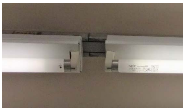
第2図 中央制御室天井照明
