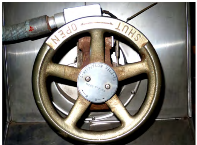
第5図 保守点検における誤操作防止
