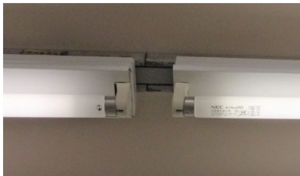
第2図 中央制御室天井照明
