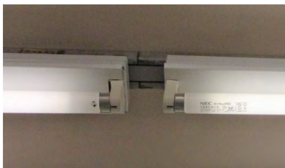
第2図 中央制御室天井照明
