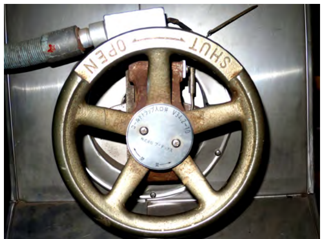
第5図 保守点検における誤操作防止
