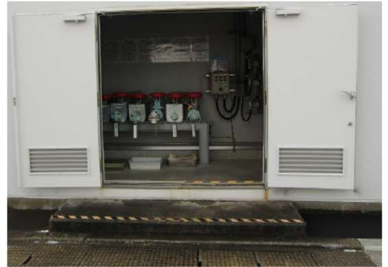
接続口の扉（開放）
