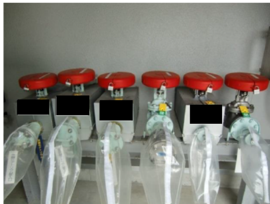
化学薬品の接続口
