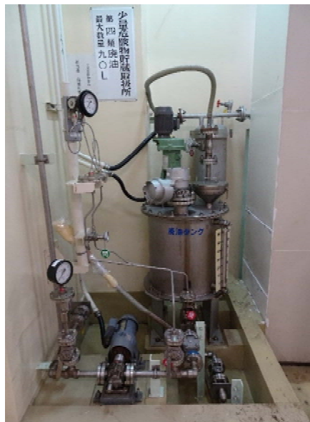
有機溶媒貯槽(β・γ 固体処理棟Ⅲ)
