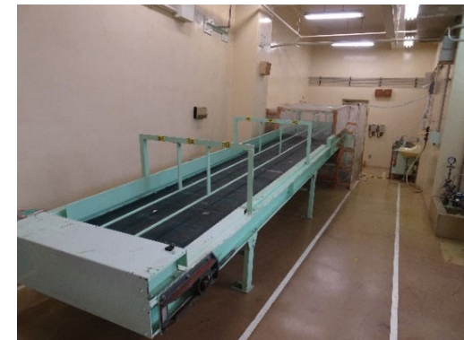
固体廃棄物投入機 (固体廃棄物ストックコンベア)
