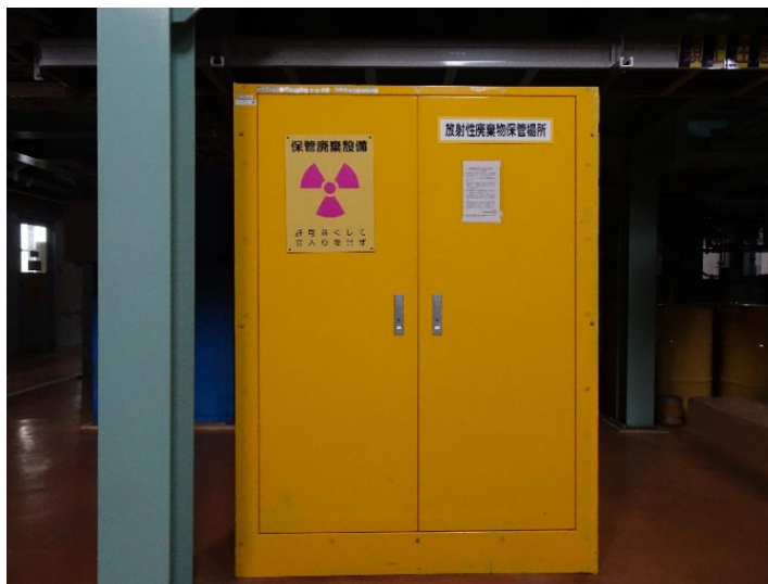
固体廃棄物の廃棄施設 ( \beta \cdot \gamma 固体処理棟 I)
