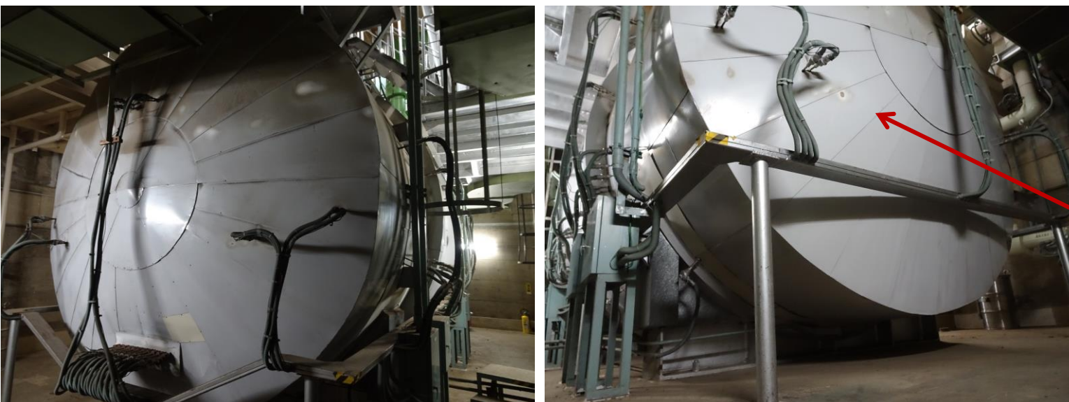
2次冷却材ダンプタンク
