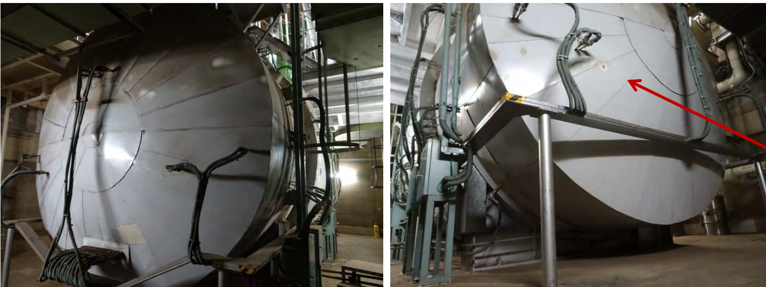
2次冷却材ダンプタンク
