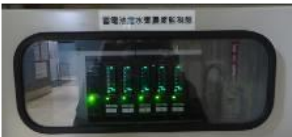
水素濃度監視盤
