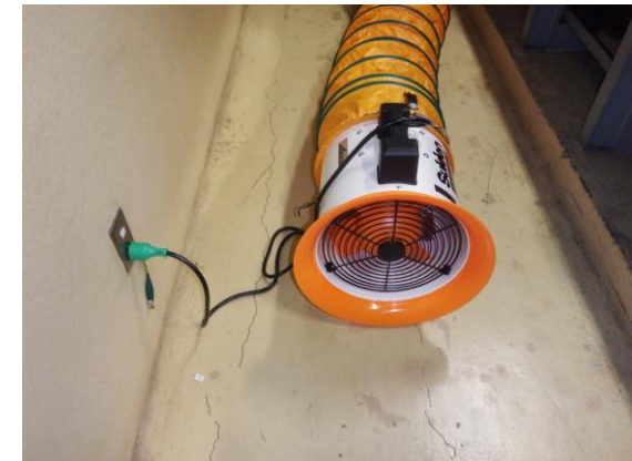
可搬式局所排気装置 (壁コンセントより電源取得) ※ 非常用電源系より給電
