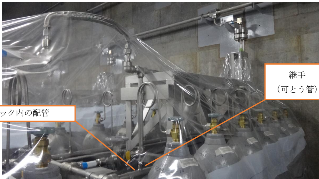
第4-2図 空気ボンベラック内の配管と継手
