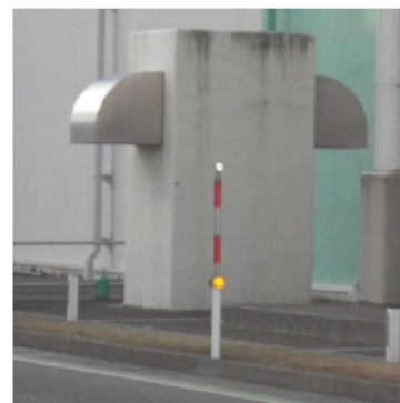
洞道の排気口
