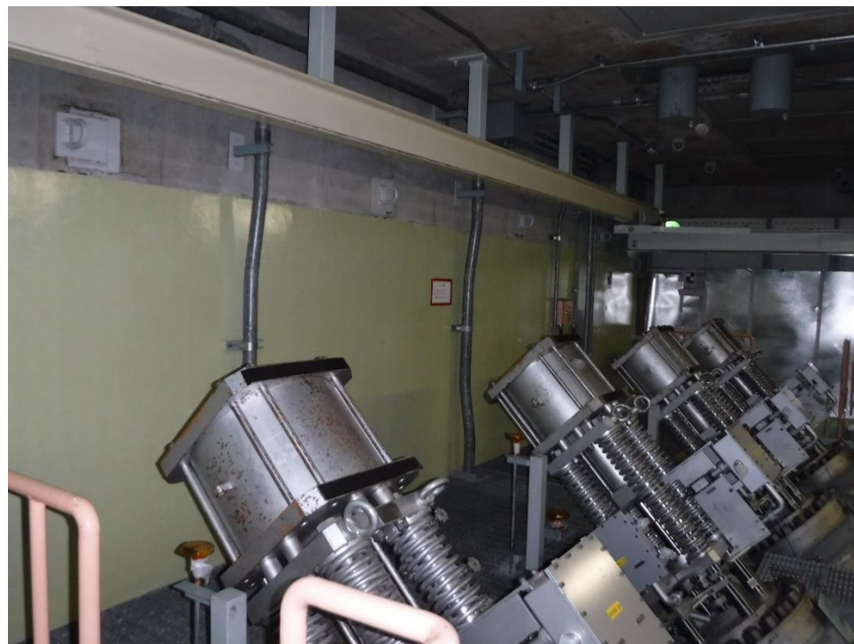
主蒸気隔離弁
