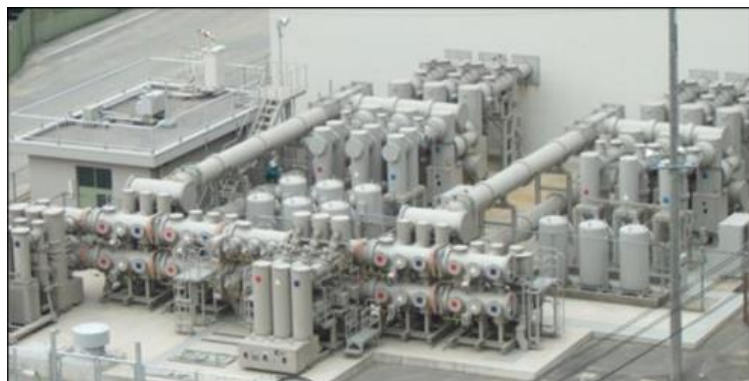
ガス絶縁開閉装置 (GIS)
