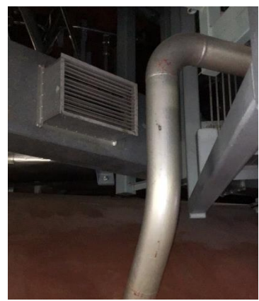
トラス室ダクト吸込口（外観）
