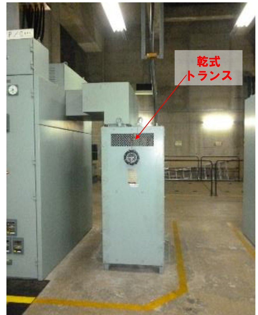
変圧器（トランス）の一例
