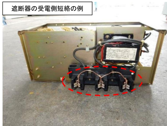
図 4-5-3 遮断器の短絡箇所 (C/C 試験時)
