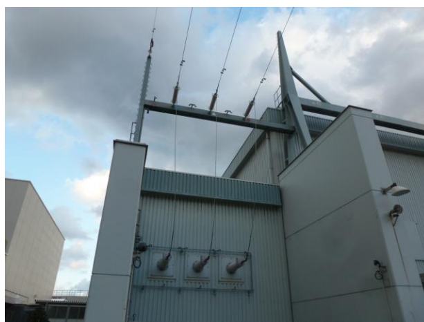
66kV 送電線引込部（イメージ）
