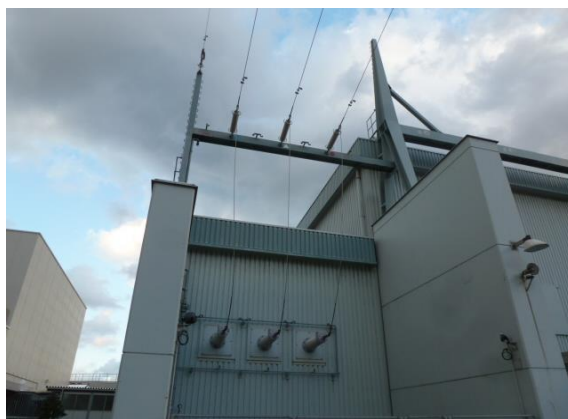
(66kV 開閉所 送電線引込部)
