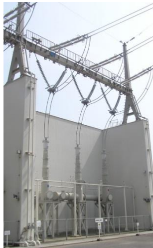
(220kV 開閉所 送電線引込部)
