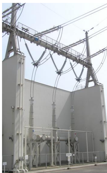
220kV 送電線引込部
