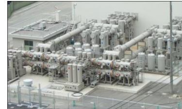
(a) 220kV 開閉所
