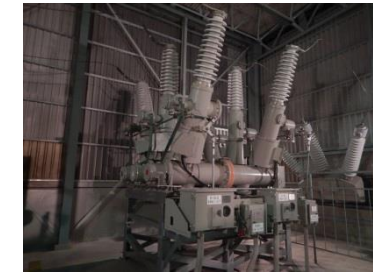
(b) 66kV 開閉所 (屋内)
