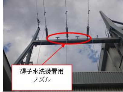
66kV 送電線（開閉所出口）
