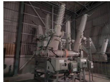
(b) 66kV 開閉所（屋内）
