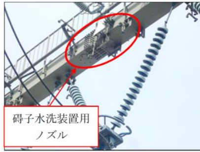
220kV 送電線（開閉所出口）
