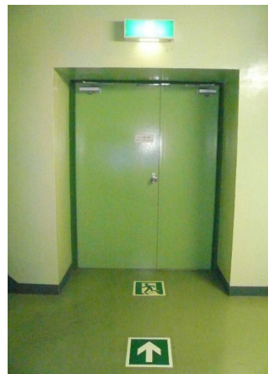
避難口誘導灯
