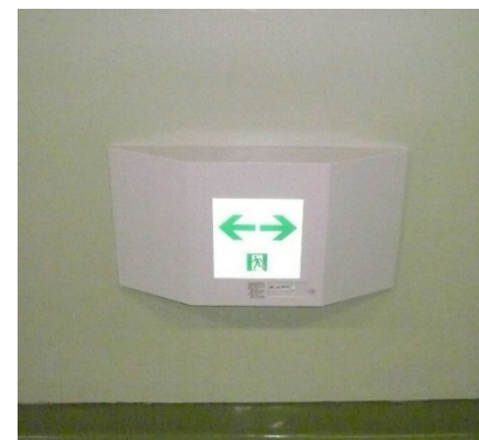
階段通路誘導灯
