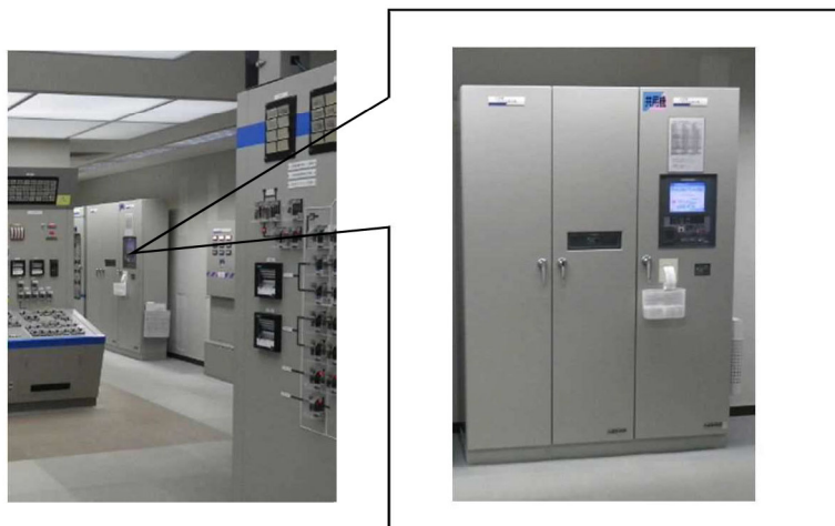
中央制御室に設置した火災受信機盤
