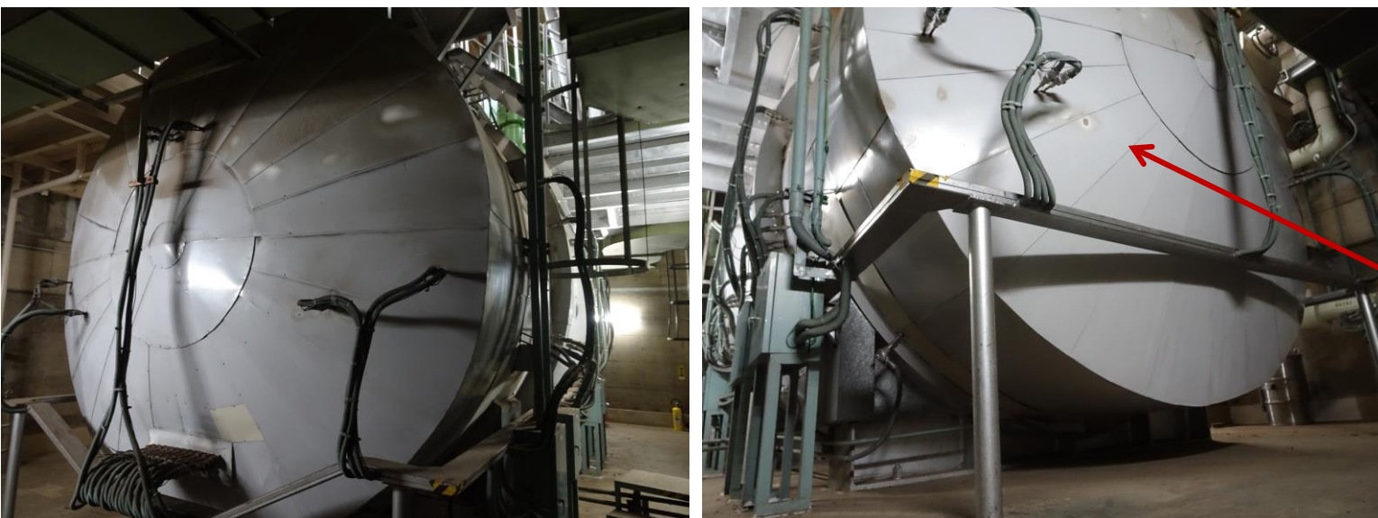
2次冷却材ダンプタンク
