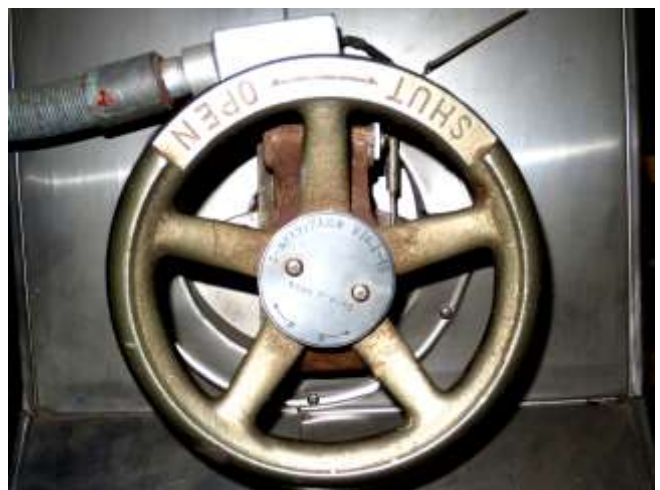
第5図 保守点検における誤操作防止
