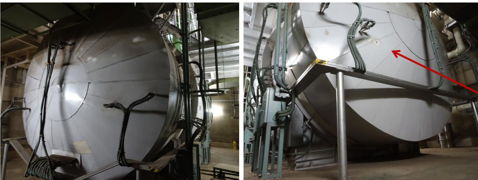
2次冷却材ダンプタンク
