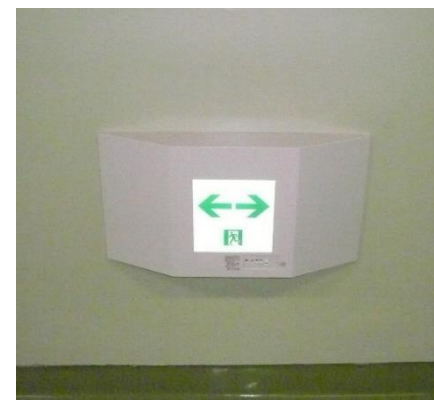
階段通路誘導灯
