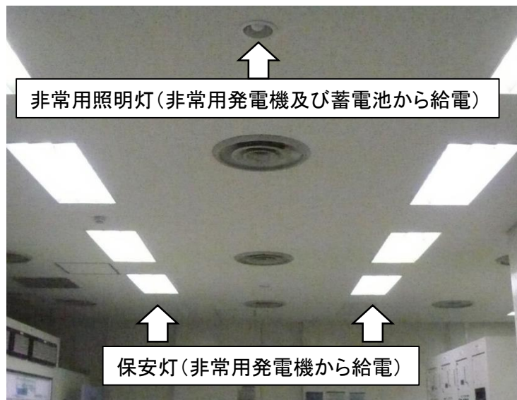
保安灯及び非常用照明灯 (保安灯のみ点灯)
