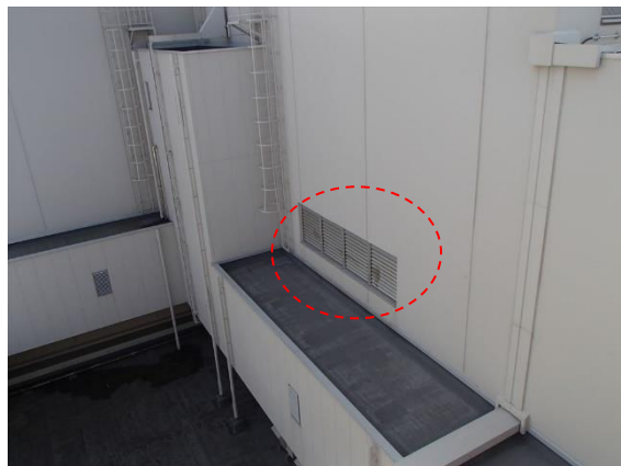
図2 中央制御室空調換気系の外気取入口
