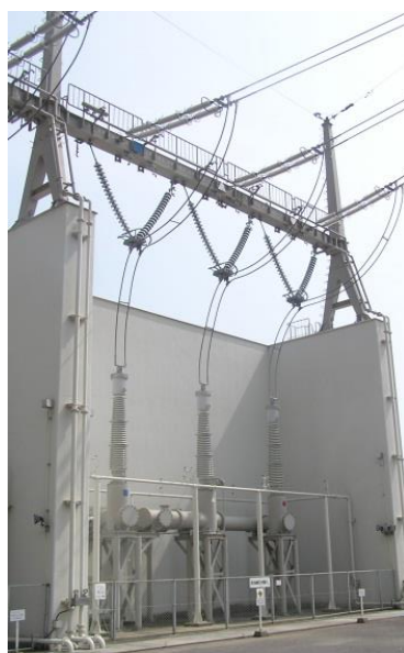
220kV 送電線引込部
