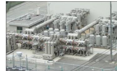
(a) 220kV 開閉所
