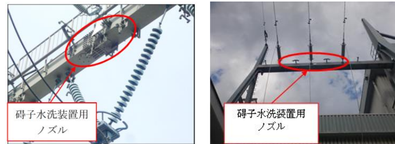
220kV 送電線 (開閉所出口)
