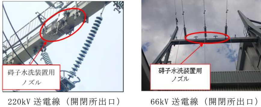
図 3-21 碍子洗浄装置外観
