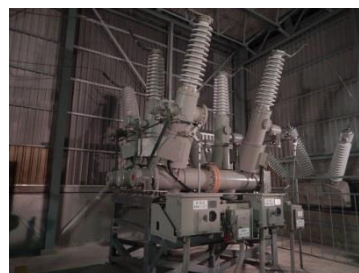
(b) 66kV 開閉所（屋内）
