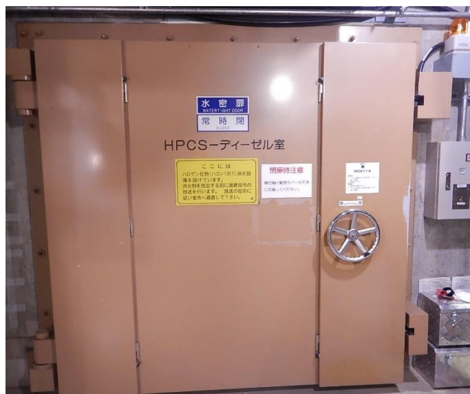
図2 水密扉設置状況
