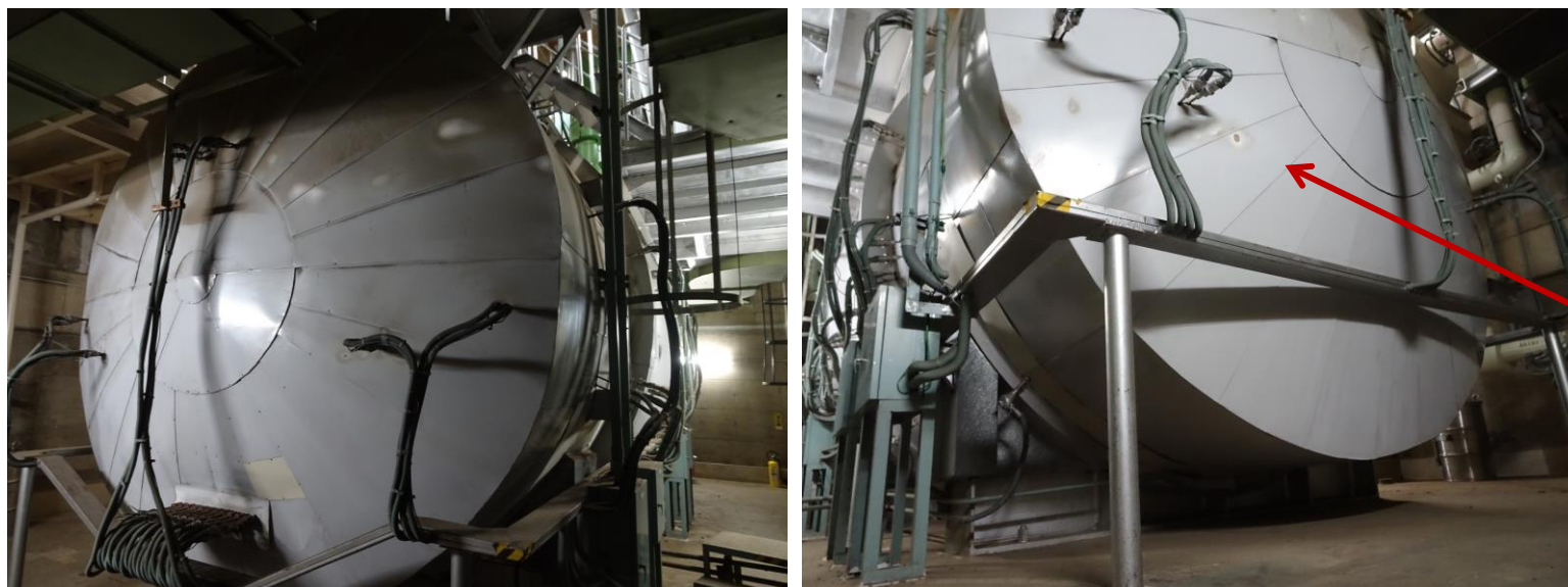
2次冷却材ダンプタンク
