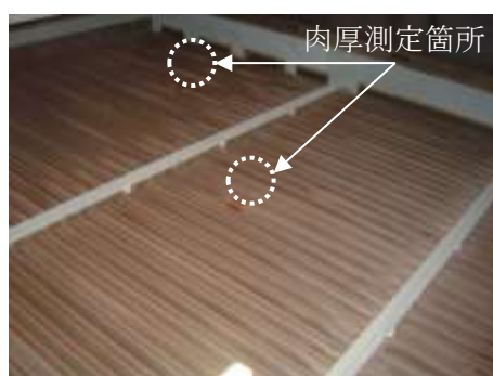
(主冷却器伝熱管外観)
