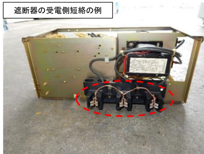
図 4-5-3 遮断器の短絡箇所 (C/C 試験時)
