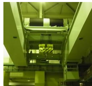
原子炉建物天井クレーン
