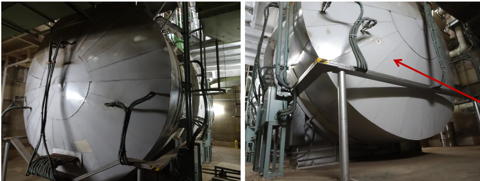
2次冷却材ダンプタンク
