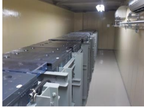
AM 用直流 125V 蓄電池
