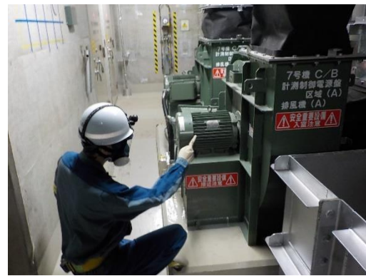
空調機運転状態確認
