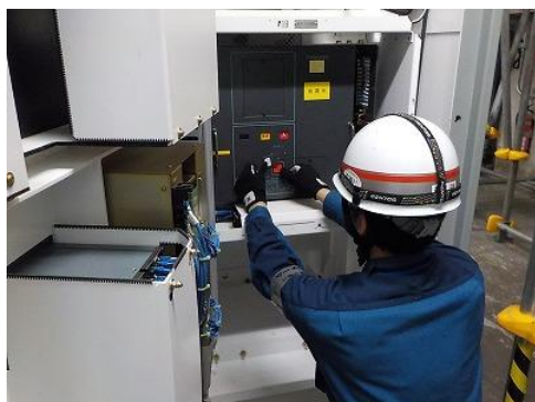
蓄電池遮断器手動開放
