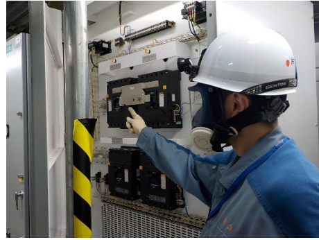
計器電源復旧 (D 系)
