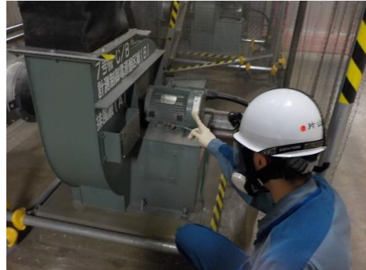
空調機運転状態確認
