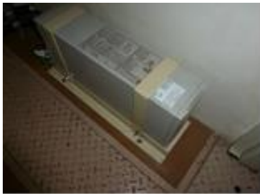
(無停電電源装置の写真)
