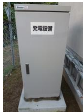
(モニタリングポスト用発電機の写真)
