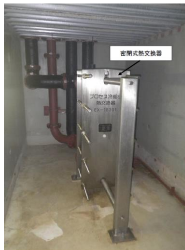
(実際の熱交換槽内部)
