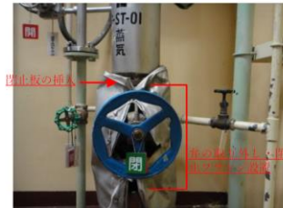
③ 弁を取り外して閉止フランジを設置するか、フランジ面に閉止板を挿入する。
