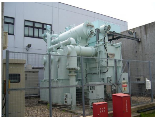
1号受電変圧器
