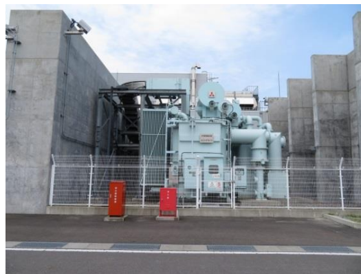
4号受電変圧器
