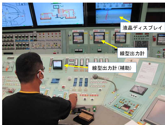
写真H-1 制御室の制御卓（運転中）
