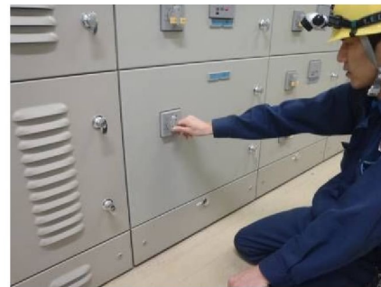
直流電源受電操作 （補助建屋 E.L. +17.0/24.0m）
