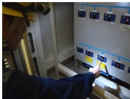
直流電源受電操作 （中間建屋 E.L. +10.1m）
