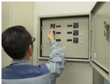
不要直流負荷切離し操作 (中央制御室 操作器)
