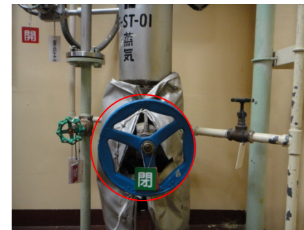
③ 弁の操作ハンドルにカバーをかぶせ、南京錠等で施錠
