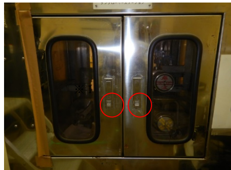
① 廃液の受入口 (タンクローリーステーション) の扉を施錠
