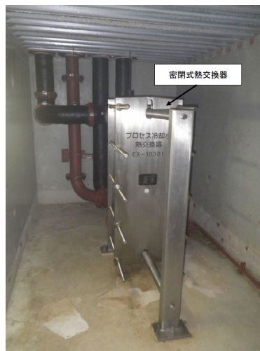
(実際の熱交換槽内部)
