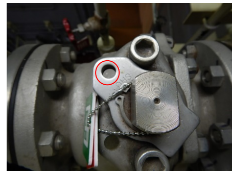
② 弁棒側の穴と弁体側の穴を合わせて南京錠等で施錠
