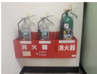
消火器設置状況
