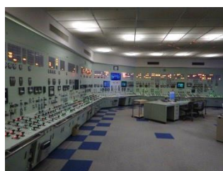
直流非常灯点灯時
