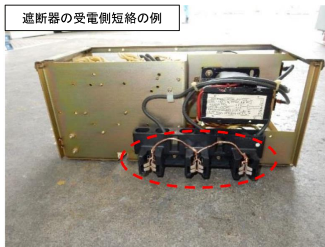
図 4-5-3 遮断器の短絡箇所 (C/C 試験時)
