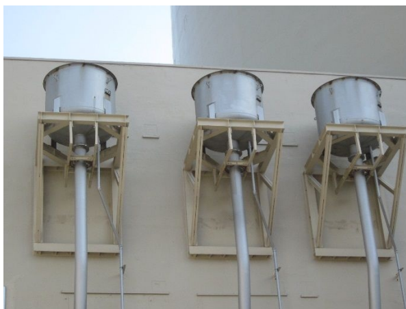
図3 主蒸気逃がし弁消音器の設置状況
