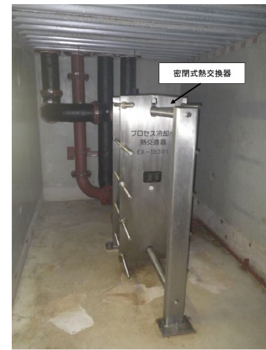
(実際の熱交換槽内部)
