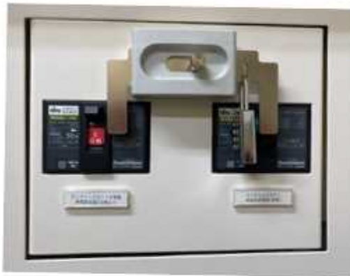
AC-DC電源切替盤 (メカニカルインターロック部)
