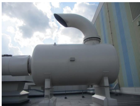
図 2-8 ディーゼル発電機排気消音器及び排気管
